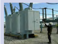
ตรวจสอบหม้อแปลงไฟฟ้าขนาดใหญ่
