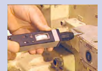
ตรวจสอบโซลินอยด์วาล์ว
