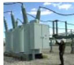
ตรวจสอบหม้อแปลงไฟฟ้า ขนาดใหญ่
