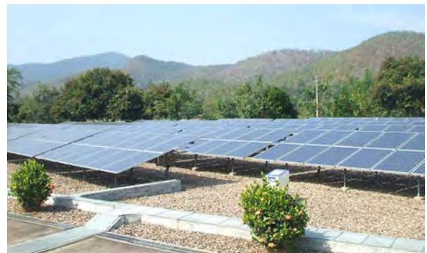
สถานีไฟฟ้าพลังแสงอาทิตย์ผาบ่อง จังหวัดแม่ฮ่องสอน
