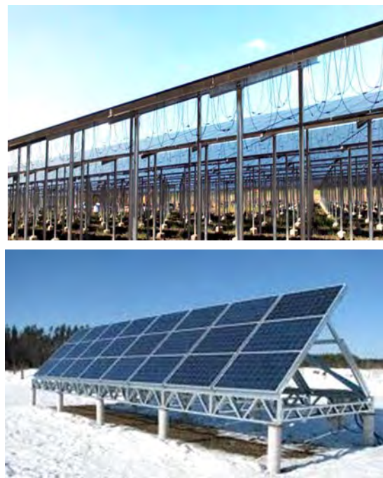
แผงโซลาร์เซลล์ (PV Array)
