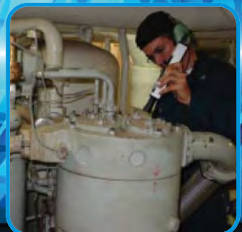
ตรวจสอบคอมเพรสเซอร์โรงงาน
