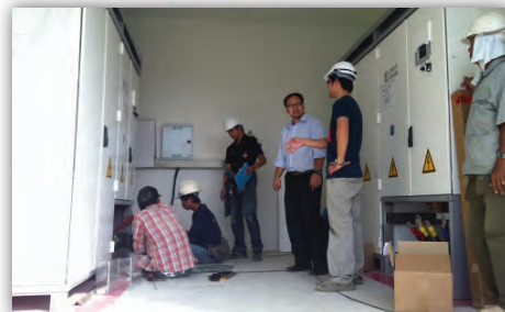
FLUKE 1550C ตรวจวัดค่าความเป็นฉนวนทางด้านขาออกของเครื่องแปลงพลังงานกับหม้อแปลง
