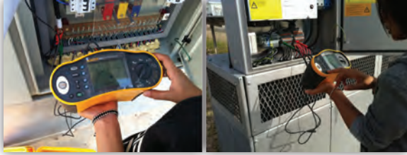
ตรวจสอบวัดค่าความเป็นฉนวนจุดต่อสายที่ DC Switch Box
