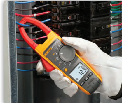
ใช้ Clamp Meter ตรวจสอบวัดกระแสที่สายที่ร้อนผิดปกติ
