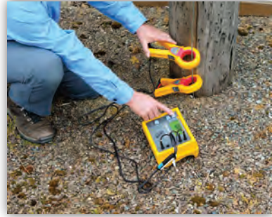
FLUKE 1625-II ในการวัดความต้านทานบอบหลายกราวด์ที่ต่อลงไปที่เชื่อมกับระบบหลายกราวด์ที่เดินใต้ดิน
