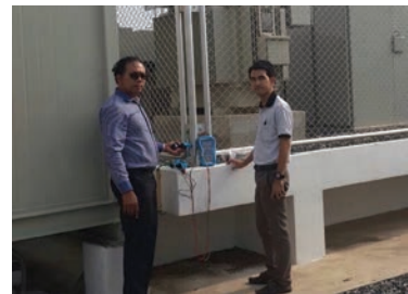
การวัดระบบกราวด์ที่สถานไฟฟ้า
