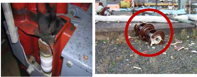
ตัวอย่างความเสียหายจาก Partial Discharge ในอุปกรณ์และฉนวนไฟฟ้าแรงสูง
