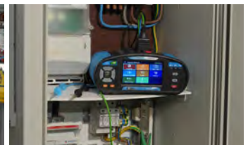
ตรวจวัดกระแสรั่วไหล ทดสอบการดำเนินงานของเครื่องตัดไฟรั่วอัตโนมัติ
