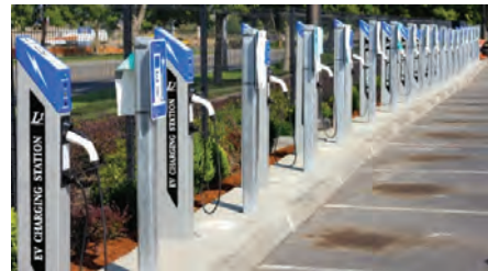
สถานีชาร์จสาธารณะที่ติดตั้งกลางแจ้ง
