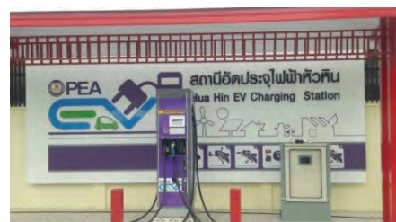
สถานีชาร์จสาธารณะแบบ การไฟฟ้าภูมิภาค แบบ 3 หัวจ่าย
