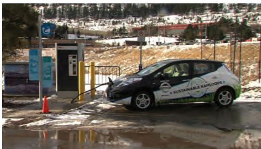
สถานีชาร์จรถยนต์ไฟฟ้ากับสภาพที่แฉะชื้น
