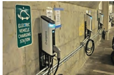
สถานีชาร์จสาธารณะที่ติดตั้งในอาคารแบบติดผนัง
