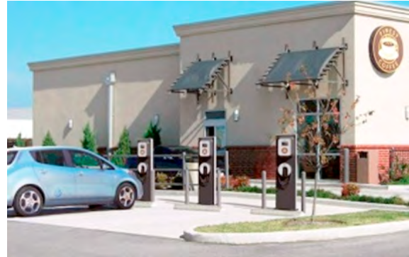
สถานีชาร์จรถยนต์ไฟฟ้ากลางแจ้ง
