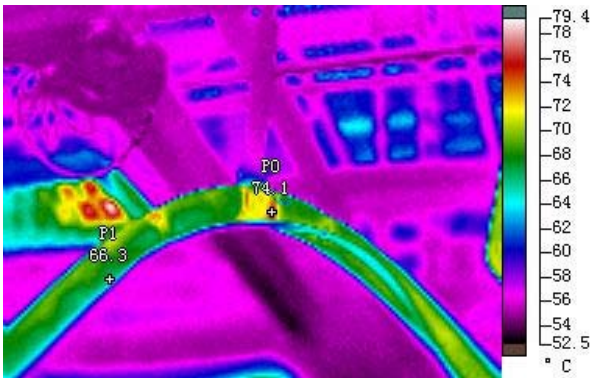
รูปที่ 1 แสดงความแตกต่างของอุณหภูมิ ณ จุดต่างกันบนสายไฟเส้นเดียวกัน
